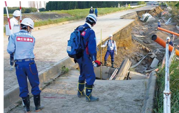
市道路肩崩落の被災状況調査 (茨城県水戸市地先)
