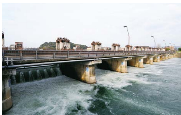
瀬田川洗堰(琵琶湖からの自然の唯一の流出口)【写真提供：国土交通省 近畿地方整備局 琵琶湖河川事務所】
