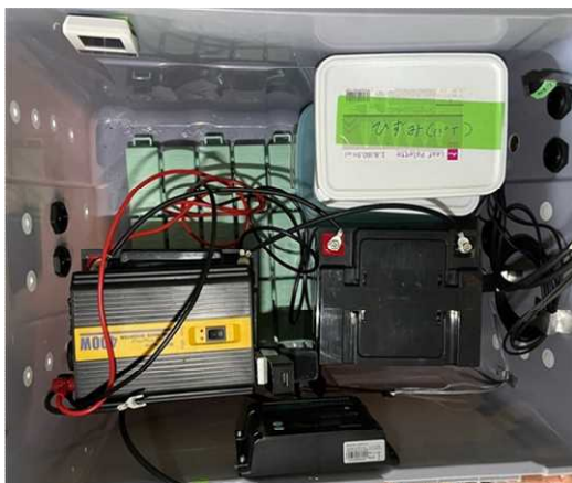
写真-7 コンテナボックス内部の様子
