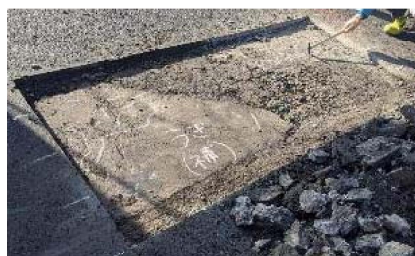
写真-2 RC床版上面の土砂化
