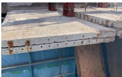
写真-1 RC床版内部の水平ひび割れ
