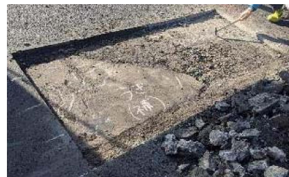
写真-2 RC床版上面の土砂化
