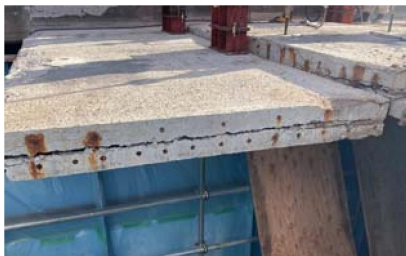
写真-1 RC床版内部の水平ひび割れ
