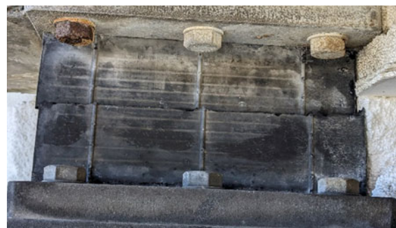
写真-1 T 橋のゴム支承破断事例
