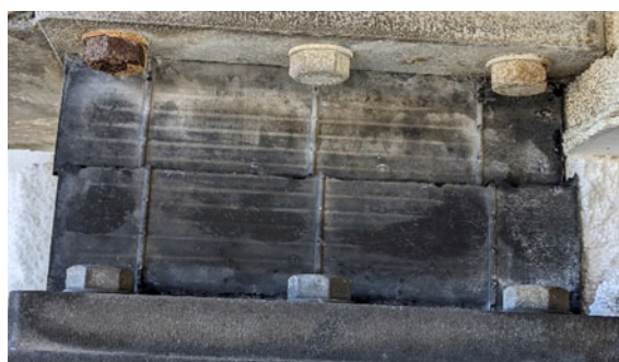
写真-1 T 橋のゴム支承破断事例
