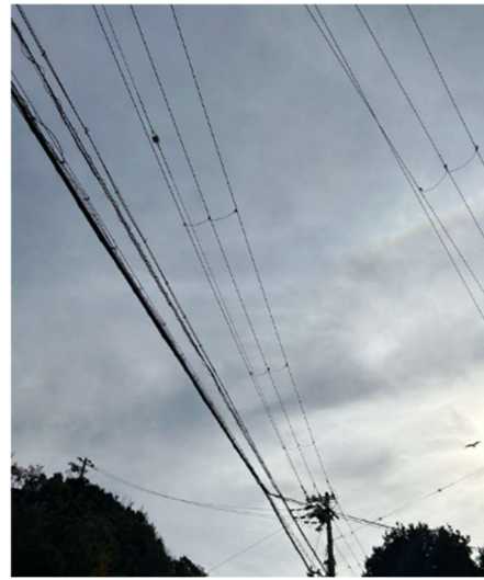
写真-10 電線の様子（白浜町）
