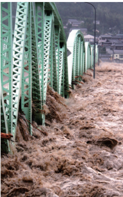
（旧）熊野大橋を越流する濁流【提供：朝日新聞社】
